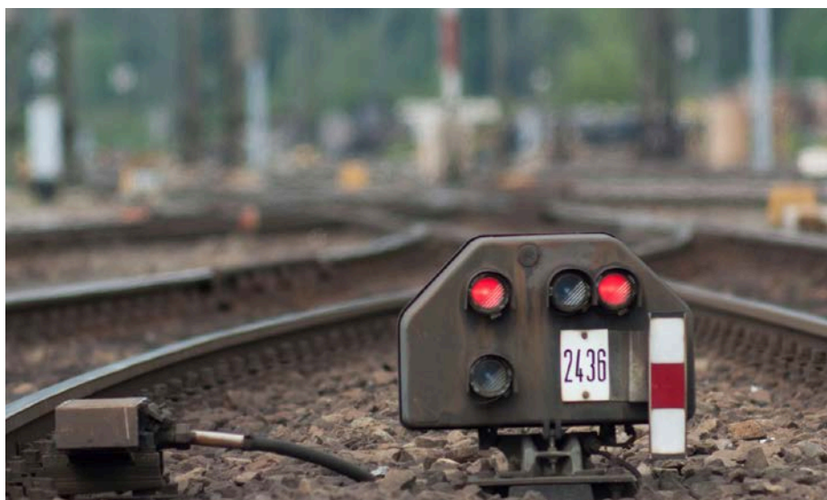
Jedes Gleis ist durch Signale in Abschnitte – sogenannte Blöcke – aufgeteilt.
